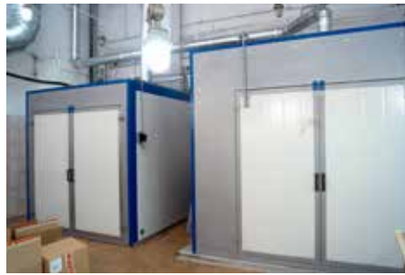
Конвекционная и терморadiaционная камеры для сушки деталей, прошедших операцию шпатлевания
